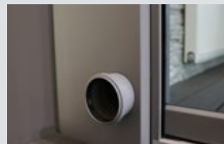
Tebau Linea mit in die Stützen integriertem Fallrohr.
